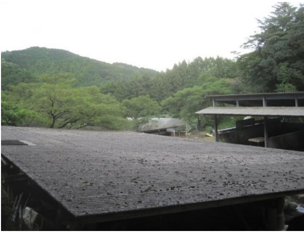
補修前 堆肥舎 屋根部分 (スレート割れ)
